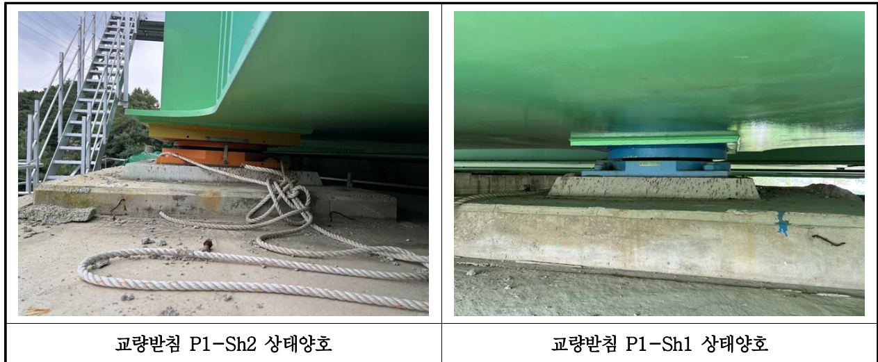
【사진 26.3.11】 교량받침 손상현황
