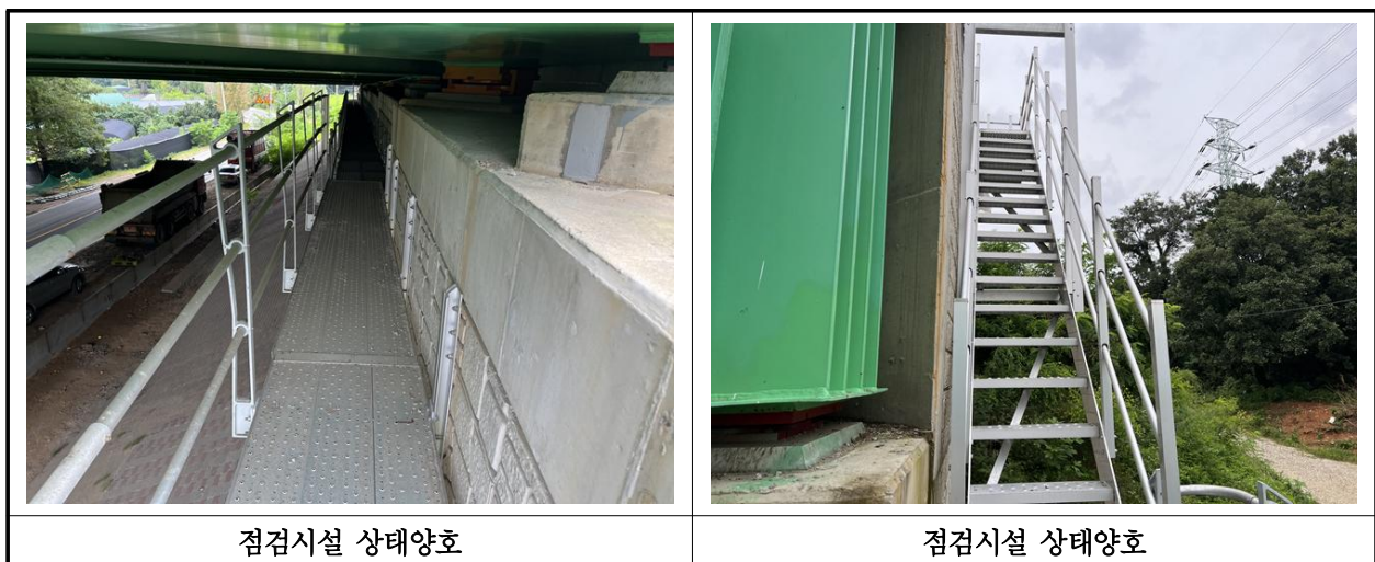
【사진 26.3.24】 교량 점검시설 손상현황
